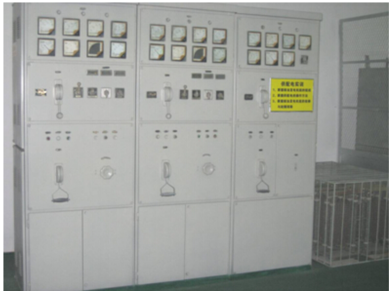
船舶电站实验室
